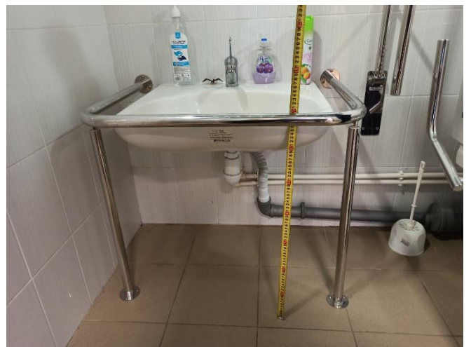
Фото 5.04. Высота установки умывальника - 0,70 м не обеспечивает свободное пространство для ног под умывальником не менее 0,75 м
