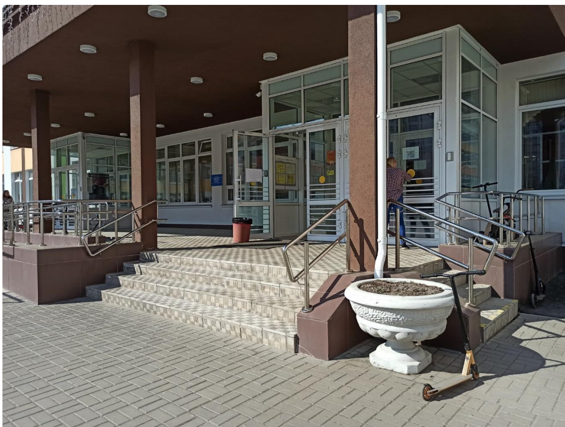
Фото 2.02. Лестница наружная. Не предусмотрены предупреждающие тактильные наземные указатели «Внимание - впереди по ходу движения лестница!» перед наружной лестницей. Отсутствуют горизонтальные окончания лестничных поручней (СП 59.13330., ГОСТ Р 51261). Ширина наружной лестницы 4,10 м. Не предусмотрен дополнительный разделительный двухсторонний поручень (при ширине марша более 4,00 м).
