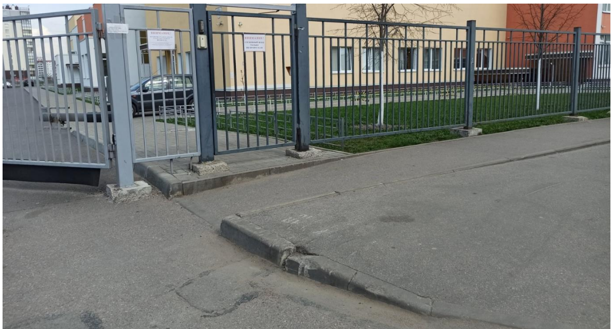
Фото 1.05. [Поз.3 на плане] Отсутствует ровная горизонтальная площадка без перепада высот перед калиткой
