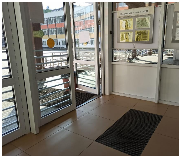
Не предусмотрено крепление к полу грязесборных ковровых покрытий на наружной площадке.
