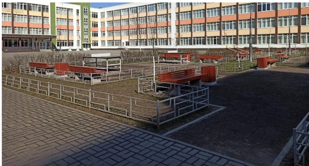
Фото 1.09. МАФ скамьи уличные. На территории объекта, в местах отдыха и на площадках не предусмотрены скамьи, доступные для МГН - оборудованные спинками и подлокотниками. Покрытие площадки недопустимого типа
