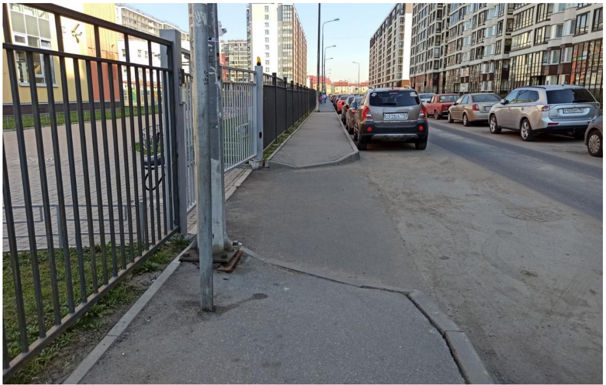
Фото 1.02 - 1.04. [Поз.2 на плане. Въезд 1] Перепад высот тротуара и проезжей части - 0,05 - 0,08 м. Недопустимый при движении на кресле-коляске по тротуару
