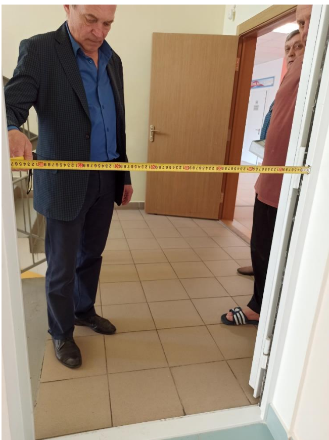
Фото 3.11. Пожаробезопасная зона. Дверной проем - 0,82 м (при открывании двери на 90 град.) Нарушение п. 6.2.4 СП 59.13330.2020. На дверях (или рядом) выхода на лестничную клетку, входа в зону безопасности и внутри помещения отсутствует знак Е21 по ГОСТ 12.4.026-2015, идентифицирующий помещение
