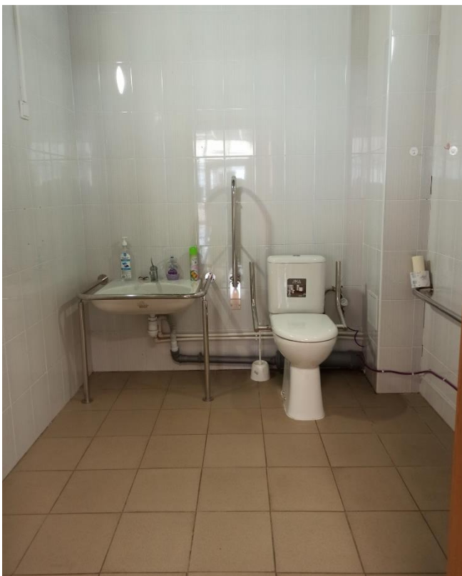
Фото 5.03. Оборудование санузла. Не предусмотрено место для парковки кресла-коляски параллельно унитазу шириной не менее 0,80 м. Не предусмотрена или установлена некорректно система вызова помощи
