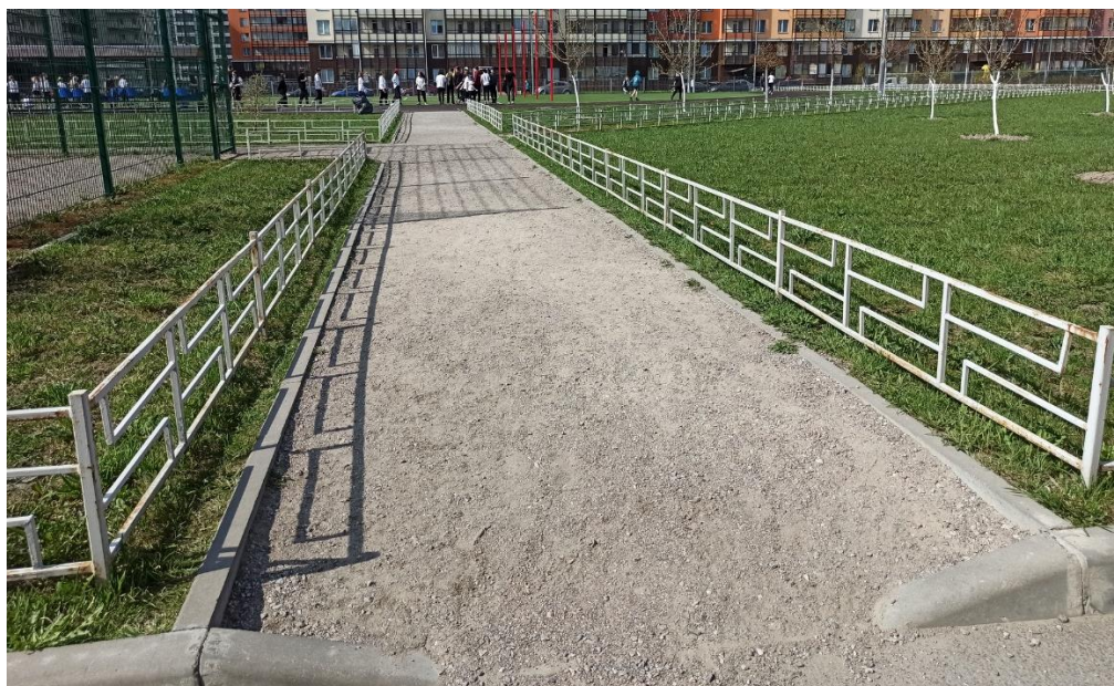
Фото 1.10. [Поз.4 на плане] Дорожка к футбольному полю. Не допускается применение щебеночно-набивного покрытия дорожек на путях движения инвалидов на креслах-колясках.
